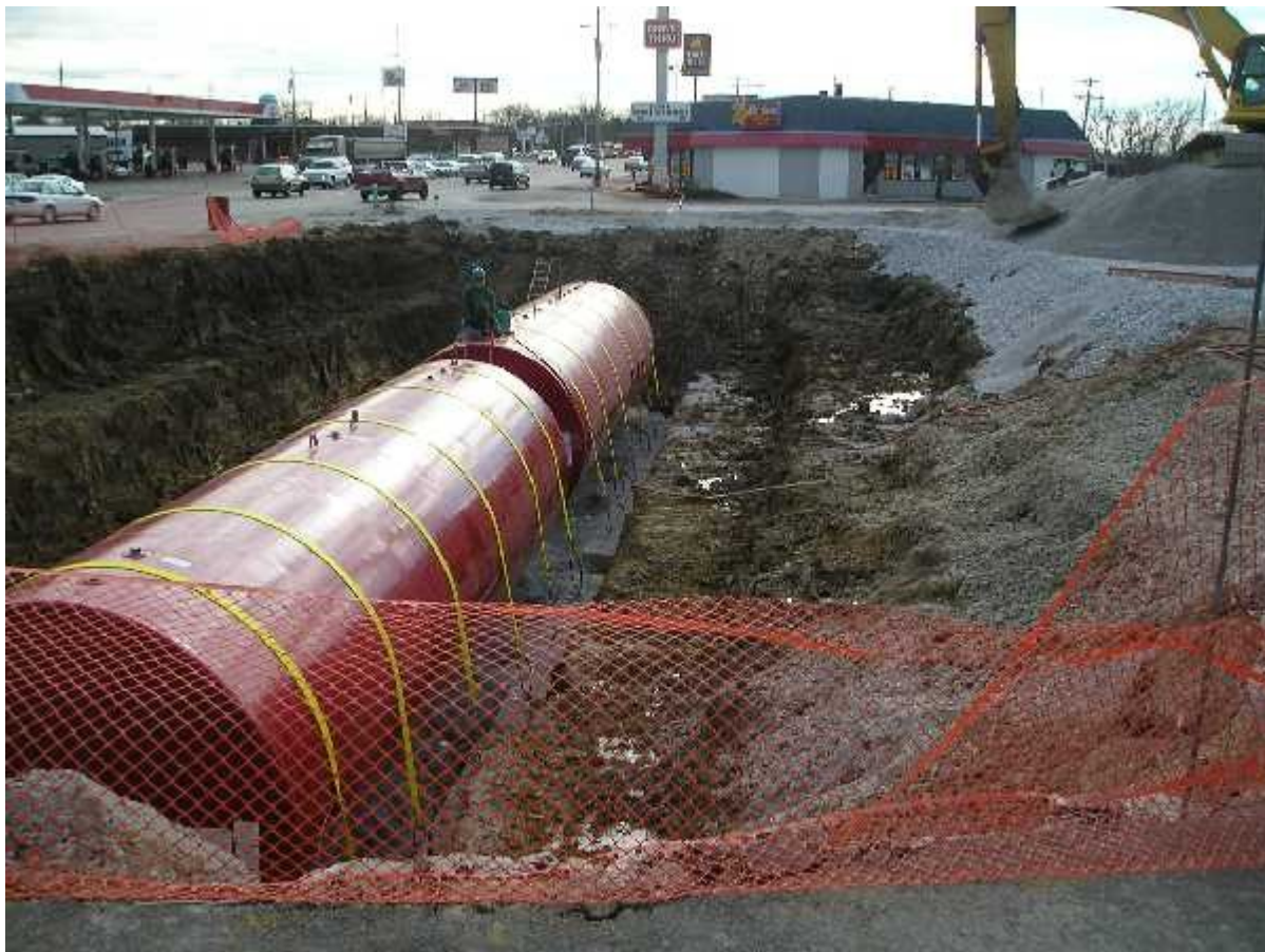
Figura 2.9 – Serbatoi sotterranei di stoccaggio 17
