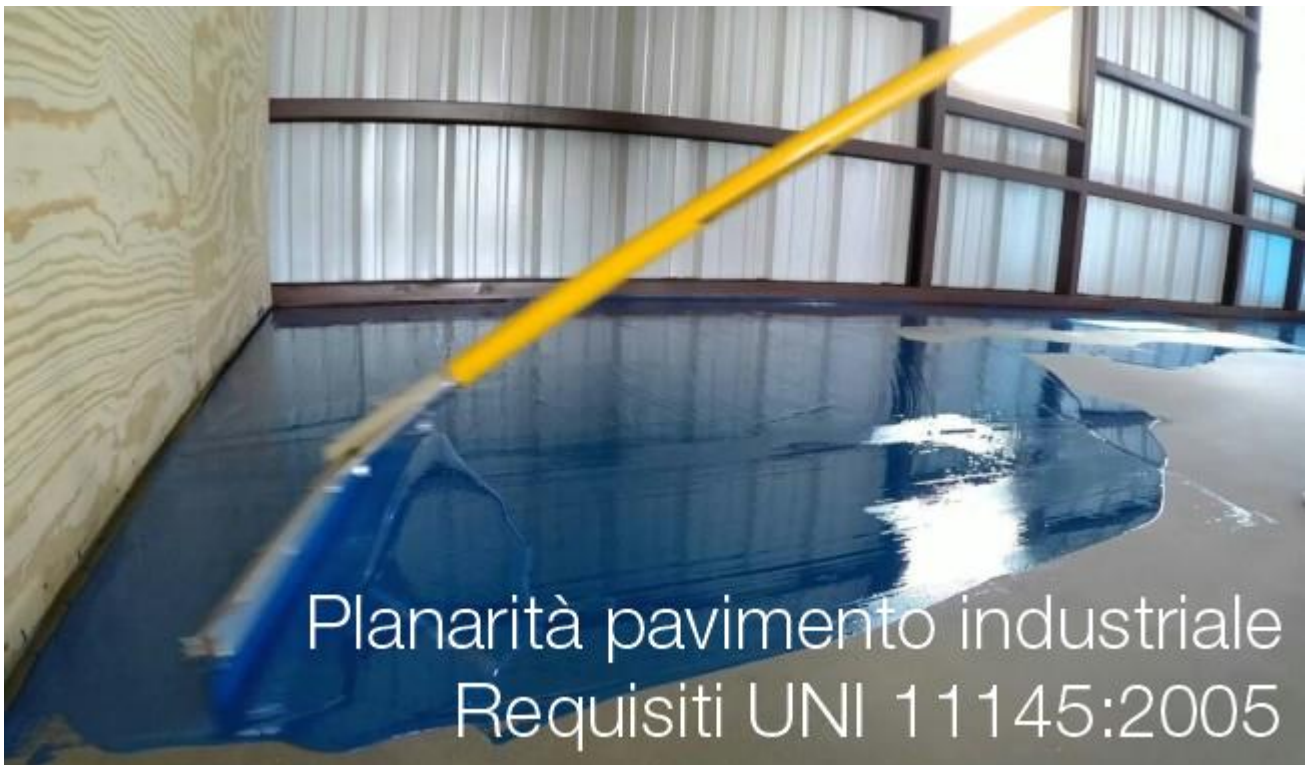
Fig. 1. - Planarità pavimento industriale
