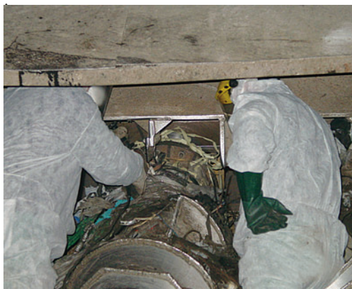
Operazioni di pulizia all'interno del tritatore
